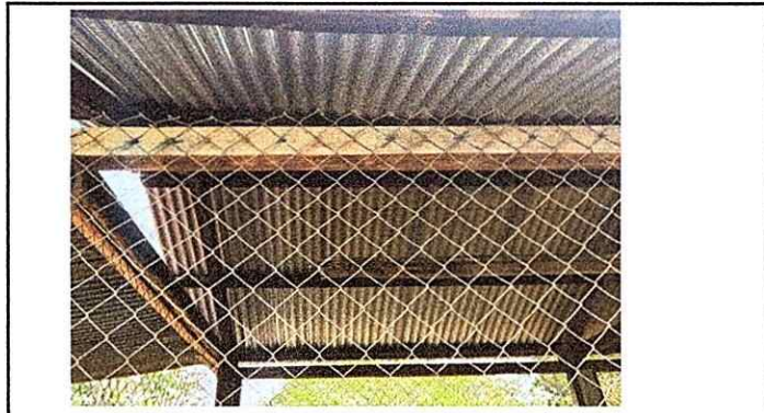
Foto 4: Estructura en mal estado
