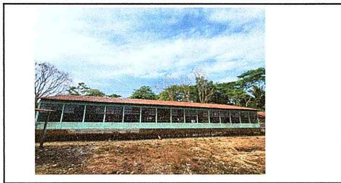
Foto 5: Cubierta de lamina requiere ser sustituido
