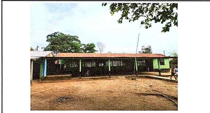
Foto 1: Cubierta de lamina en mal estado
