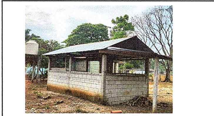
Foto 3: la estructura y cubierta de techo en mal estado
