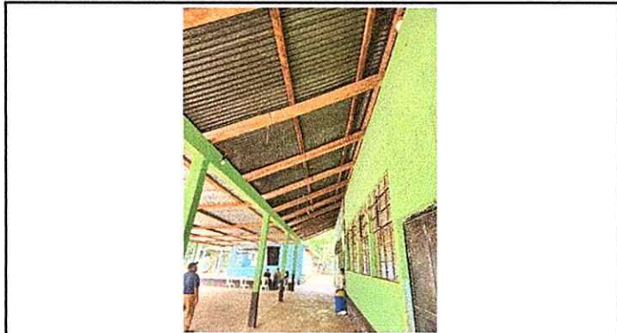
Foto 2: Estructura de madera en mal estado, requiere cambio
